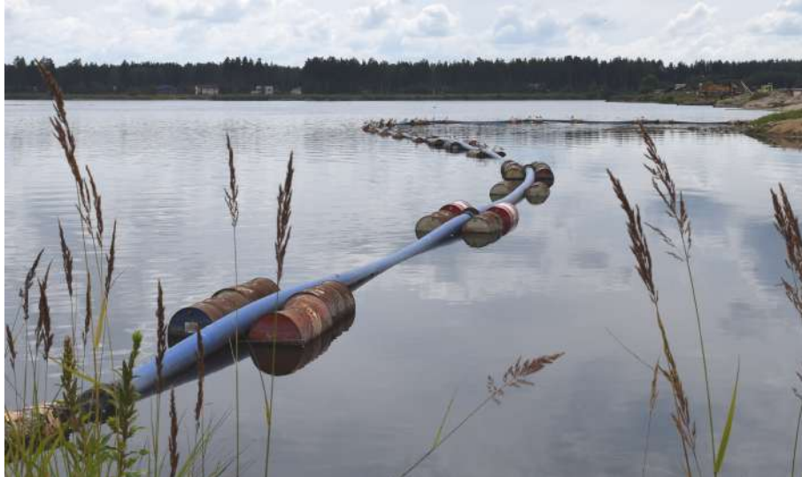
1.9. attēls. Sapropeļa transportēšanas cauruļvads no zemessūcēja līdz Tehnoloģiskajam laukumam
